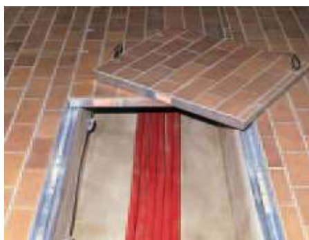
Pokrywa rzędowa do szybu kablowego
